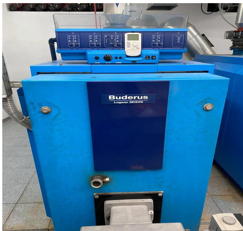
Slika 2. Plinski B-toplovodni kotao marke BUDERUS-SK 625 311
