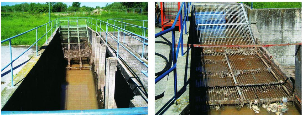
Slika 1. Grube rešetke na uređaju za pročišćivanje (Varaždin) [1]
