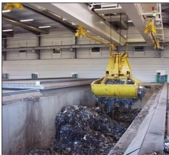
Slika 2. Premještanje biosušenog otpada procesnim kranom iz betonske komore (Preuzeto iz: Hidroplan d.o.o., 2014.)
