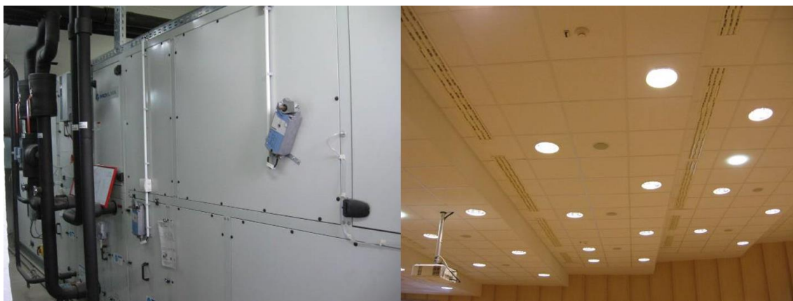
Slika 17 Klima komora Proklima KU 6-M-DU50S-S (lijevo), elementi za distribuciju kondicioniranog zraka (desno) [15]
