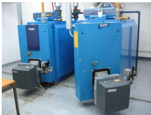
Slika 13 Dva toplovodna kotla Buderus Logano SK625-311-410 [15]
