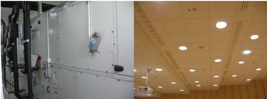
Slika 17 Klima komora Proklima KU 6-M-DU50S-S (lijevo), elementi za distribuciju kondicioniranog zraka (desno) [15]
